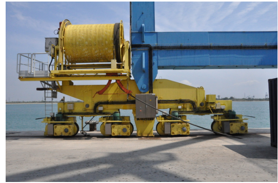
Photographie du pied de grue (le tambour supérieur permet l'enroulement du câble d'alimentation 20 000 V)
